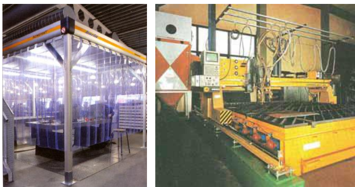
Cabina de soldadura con aspiración
