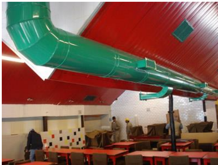
Sistema de ventilación general
